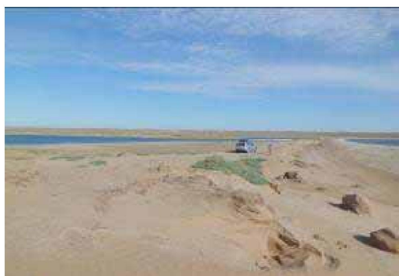
Рис. 1.2. Фрагмент разрушенной дамбы
