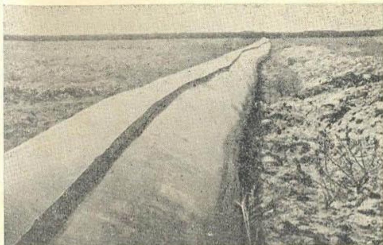
Рис. 61. Гибкий транспортирующий трубопровод диаметром 800 мм, выполнен из черной полиэтиленовой пленки путем продольной ее сварки.
