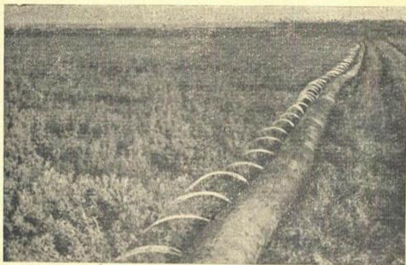
Рис. 55. Полив пастбищ и трав с помощью гибкого трубопровода.
