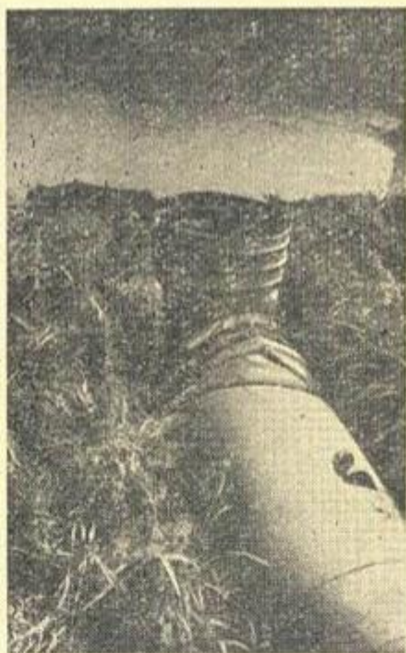
Рис. 13. Передвижной трубчатый водовыпуск для подачи воды из канала в гибкий трубопровод.
