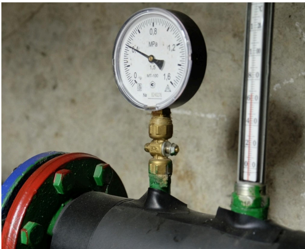
Рисунок 6 – Манометр на напорном распределительном трубопроводе (фото Д. С. Цыпленкова)
