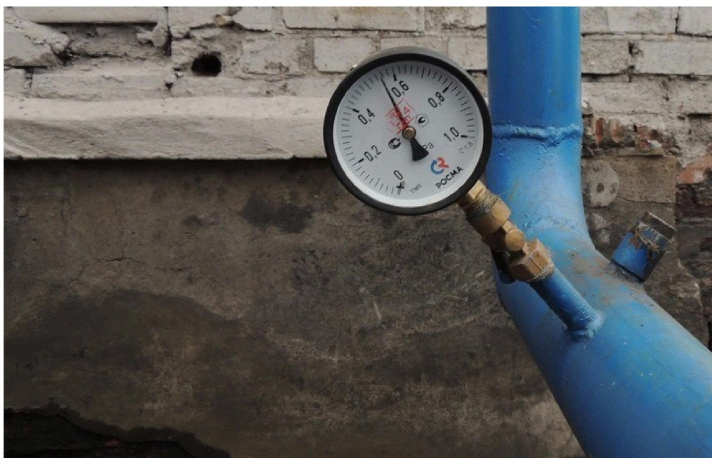
Рисунок 5 – Мановакуумметр на всасывающем трубопроводе (фото Д. С. Цыпленкова)
