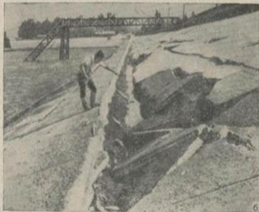
Рис. 19. Частичное разрушение плотины Сен-Фернандо. а — вид с верхнего бьефа; б — вид на низовой откос плотины.
